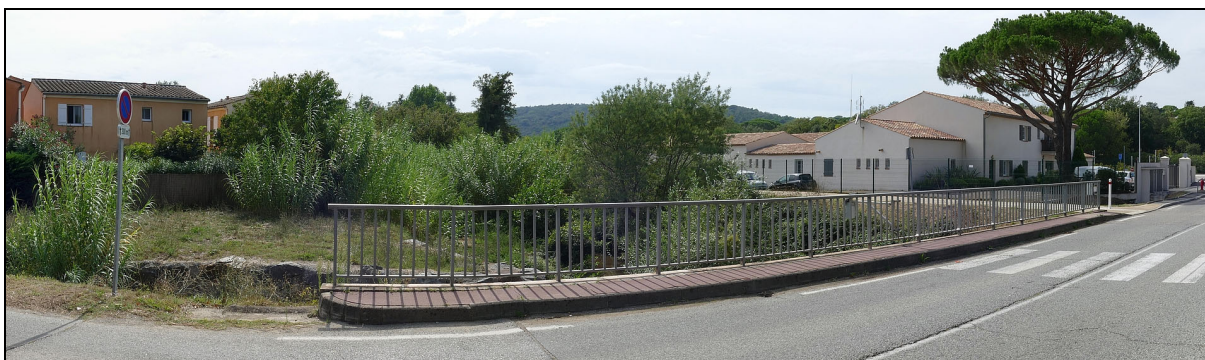
Le franchissement par la Route du Bourrian ; En arrière du pont, la ripisylve en 2019, dégradée par des travaux récents (remplacée par des cordons de canne de Provence)
