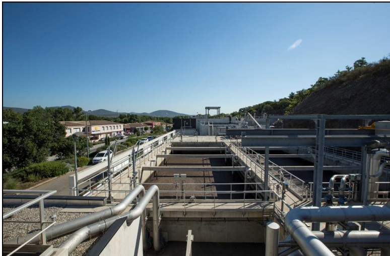
Station d'épuration de Font-Mourier à Cogolin (source : CCGST)
